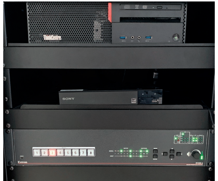
AV 讲台下方的机柜内安装有视音频切换及控制设备
