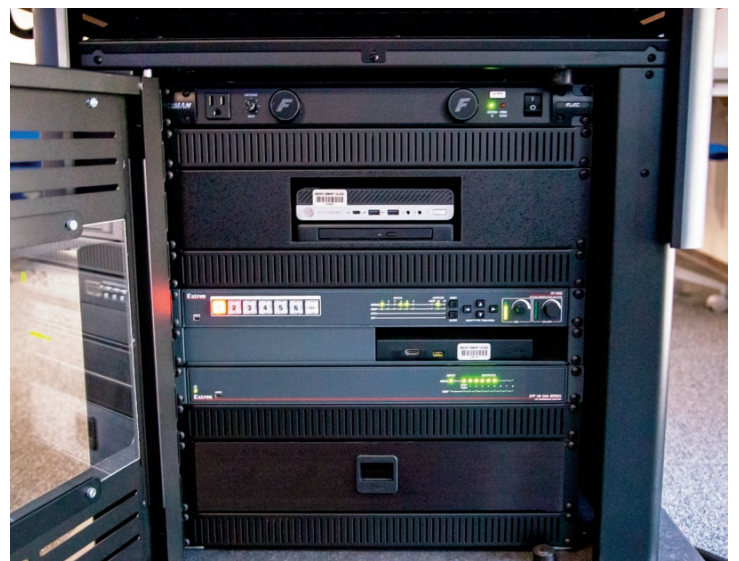
AV 讲台下方的机柜内安装有视音频切换、分配及控制设备
