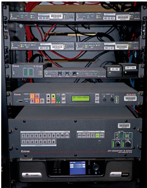
报告厅设备机柜 最上方两层安装 NAV 编码器和解码器；第三层安装 IPL Pro CR88 控制处理器和 DTP T USW 233 切换器；第四层为 SMP 351 流媒体处理器；第五层安装 DTP CrossPoint 108 4K 矩阵切换器；底层安装音频功率放大器
