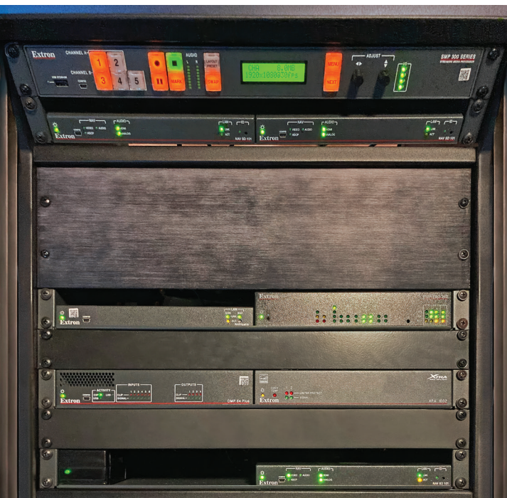
Lowboy AV rack houses core AV system equipment.
