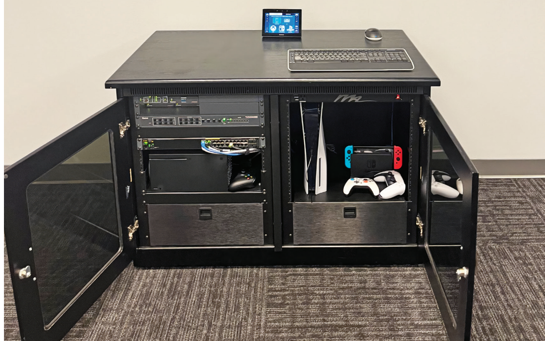
A credenza in the spectator lounge houses the main AV equipment.
